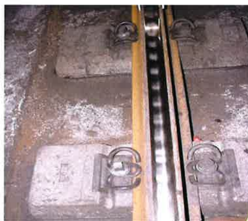
Figure 11 : Usure ondulatoire sur une section de rail.
