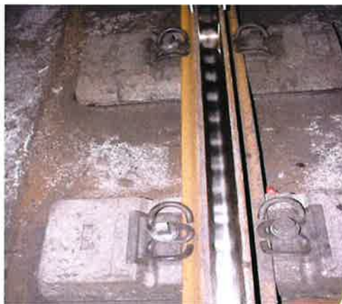
Figure 11 : Usure ondulatoire sur une section de rail.
