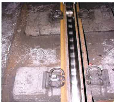
Figure 11 : Usure ondulatoire sur une section de rail.
