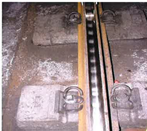
Figure 11 : Usure ondulatoire sur une section de rail.
